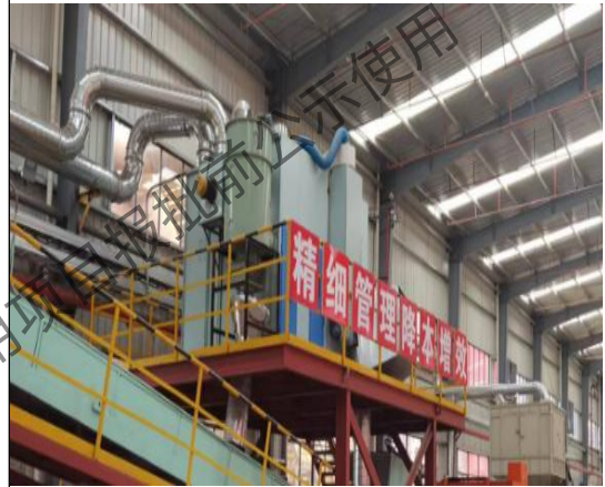
2#固废车间鼓式除尘器
