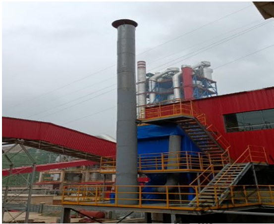
1#固废车间布袋除尘器及排气筒
